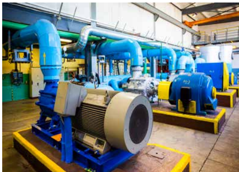
Pompownia kotłowni FUB.
