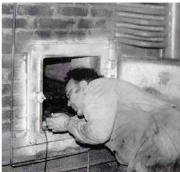
Marek Kaczan przy kotłach WLM-5 w kotłowni FUB.
