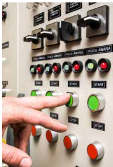
Szafa sterownicza, kotłownia FUB.
