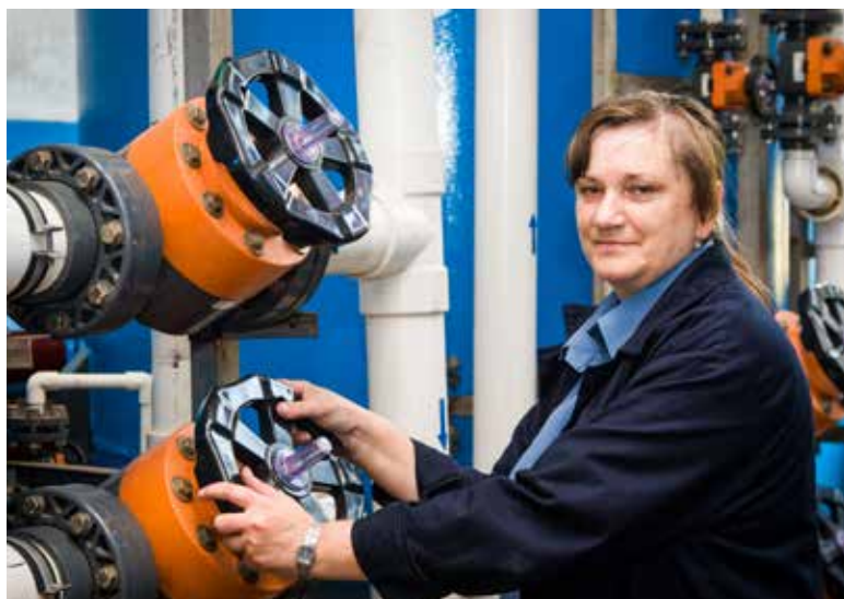
Leokadia Paszkowska, stacja uzdatniania wody kotłowni DPM.
