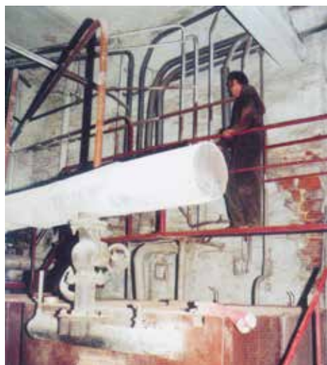
Jeden z kotłów w Prasowych Zakładach Graficznych.
