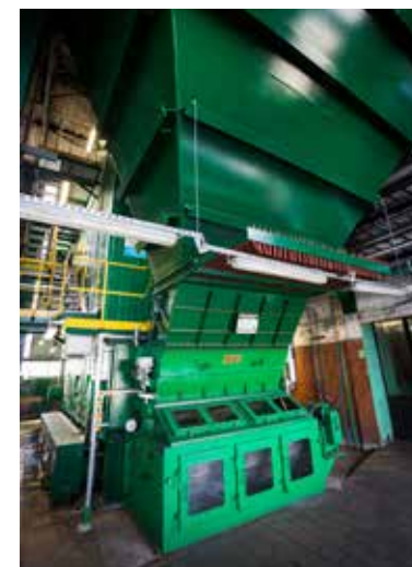
Kocioł ze ścianami szczelnymi, kotłownia DPM.
