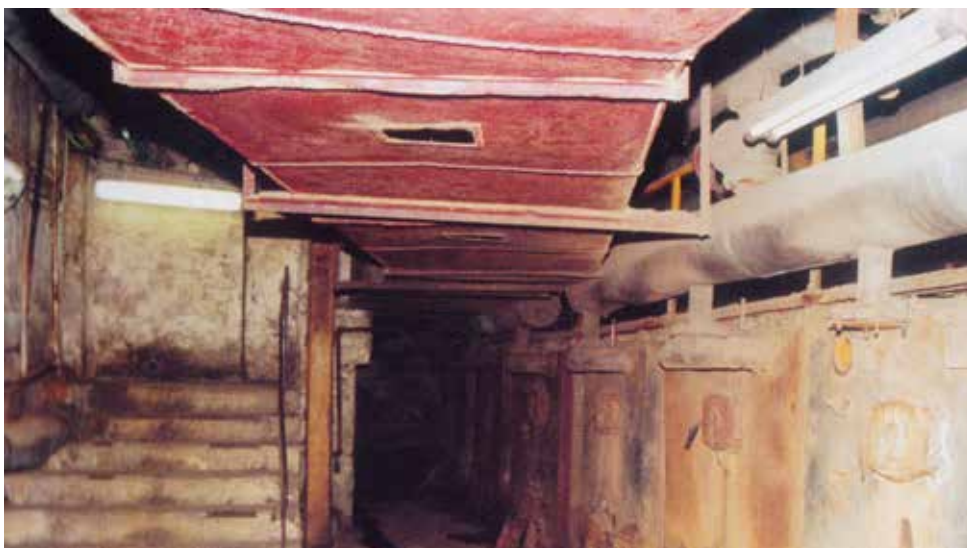
Hala kotłów w kotłowni Szpitala Wojewódzkiego w Koszalinie.
