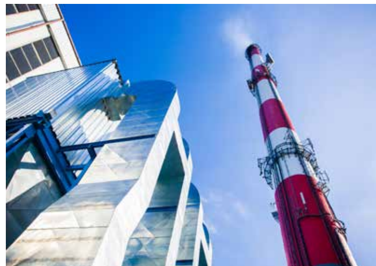
Instalacja odpylania spalin i komin, kotłownia DPM.
