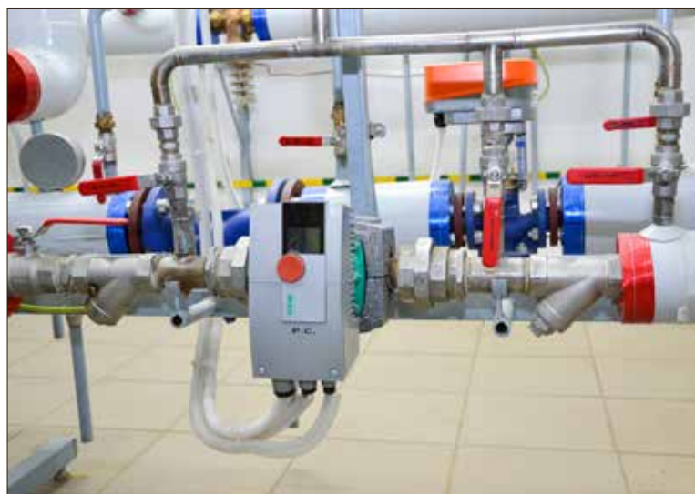
Zmodernizowany układ pompowy w jednym z węzłów ciepłowniczych.
