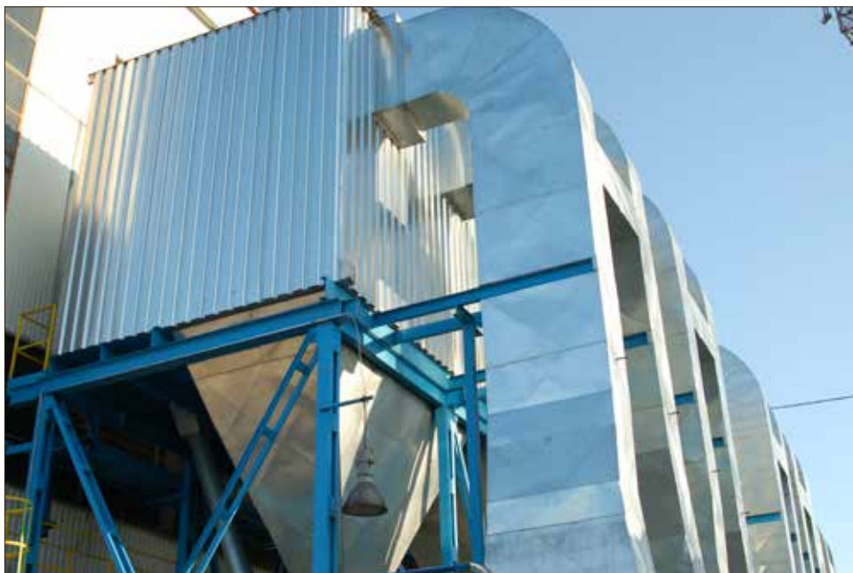
Dwustopniowy system odpylania spalin w ciepłowni DPM.
