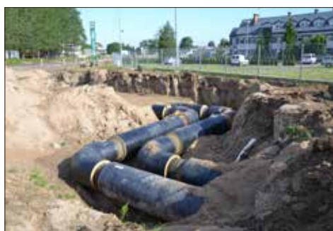
Sieci ciepłownicze wykonane w technologii rur preizolowanych stanowią już 70% całkowitej długości ciepłociągów MEC.
