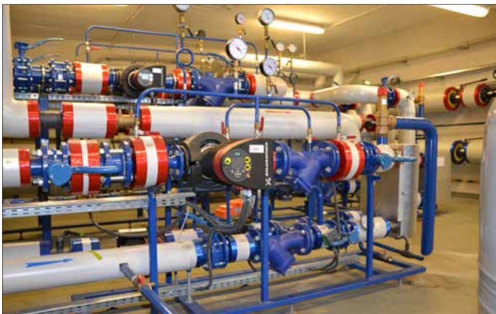
Najmniejszy z modułów węzła cieplnego odpowiada za centralne ogrzewanie.
