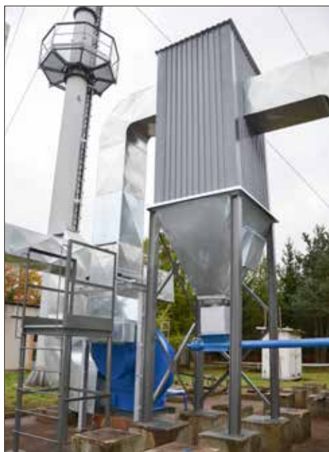
System odpylania spalin w kotłowni MEC w Sianowie.
