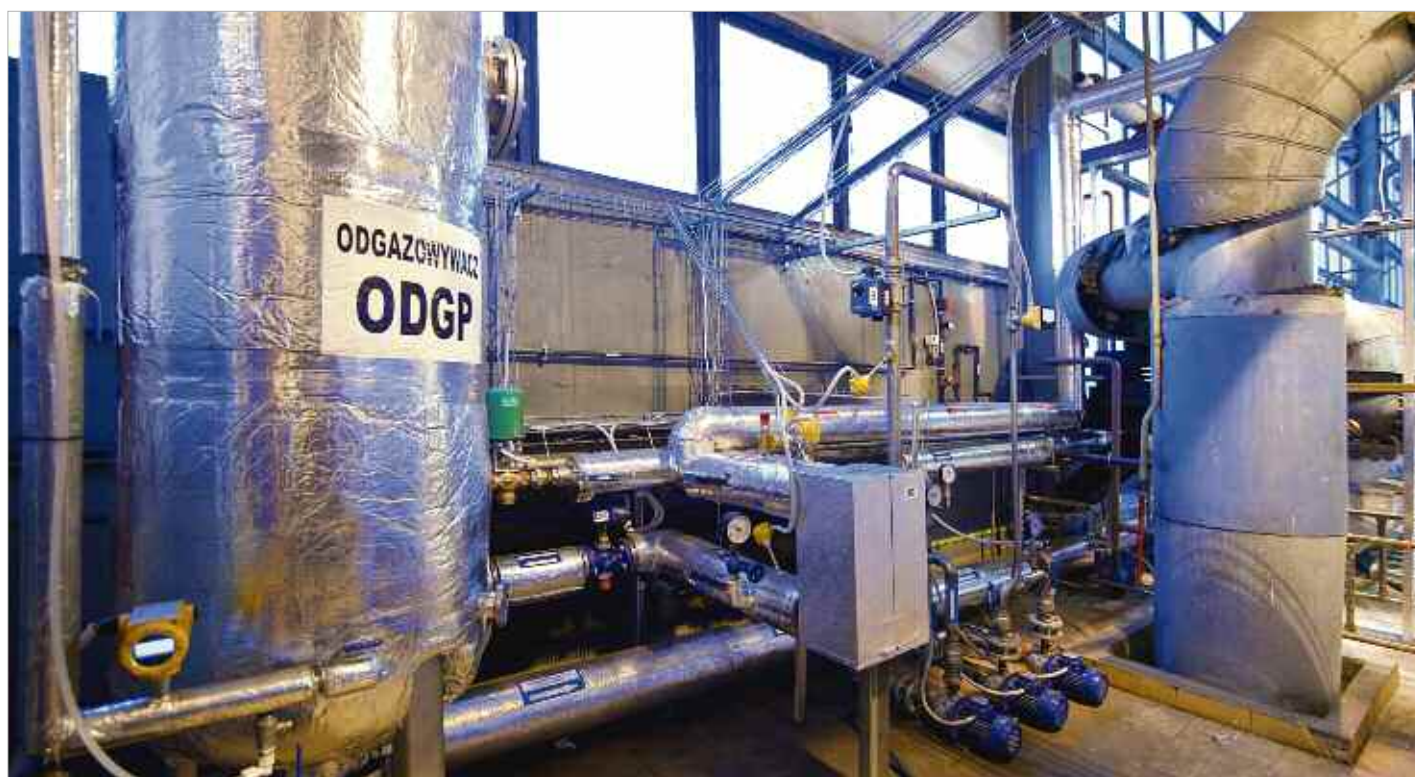
Płatanina rur, przewodów i zbiorników nie wygląda efektownie, jednak spełnia niezwykle ważne zadanie: to w nich woda jest uzdatniana do takiej postaci, by nie powodowała korozji przewodów w kotłach i rur sieci ciepłowniczej.
